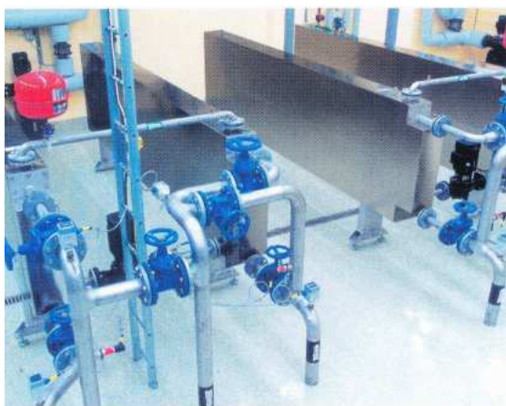
Twee warmtewisselaar units in de Vimmersby waterzuiveringsinstallatie in Zweden.
