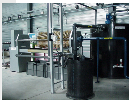
Traitement physico-chimique des eaux usées avec filtre-presse à chambre
