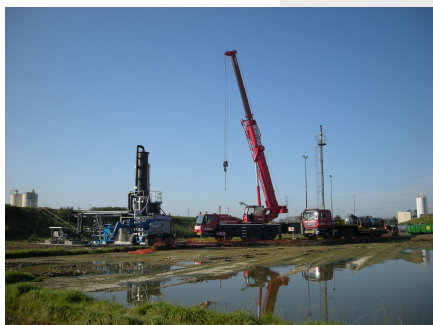
désulfuration du biogaz
