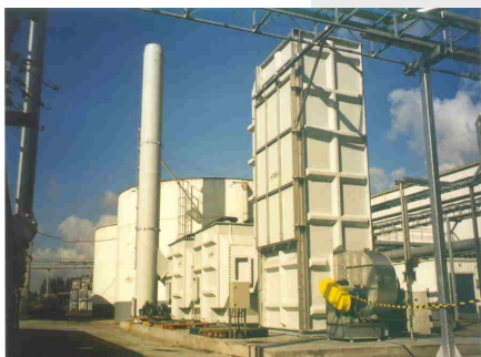
Installation de lavage de gaz à plusieurs étapes
